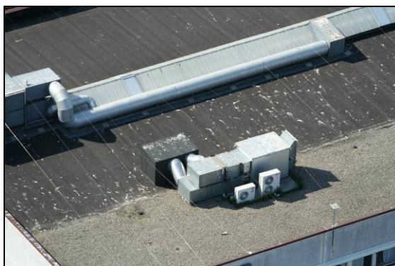
Figur 8. Senes strukket over taket for å unngå at måker skal lande. Avstanden mellom senene er imidlertid alt for stor. Det hekket tre par måker på dette taket i 2012. Foto: Bjarne Oddane.
